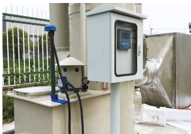
A20PR 仪表安装现场
